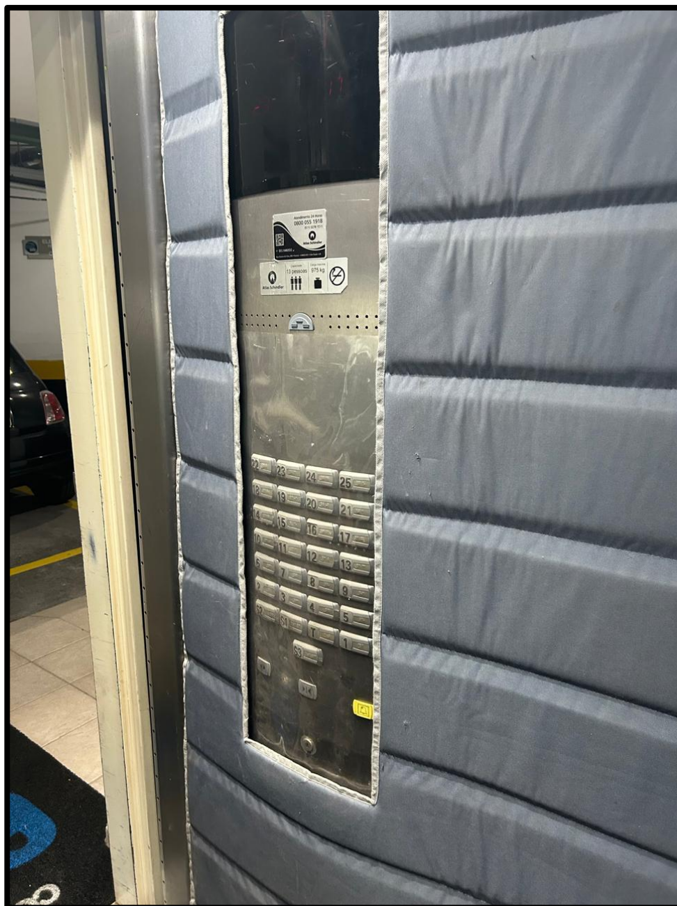
Foto nº 09 – Ilustra a botoeira de comando do elevador.
