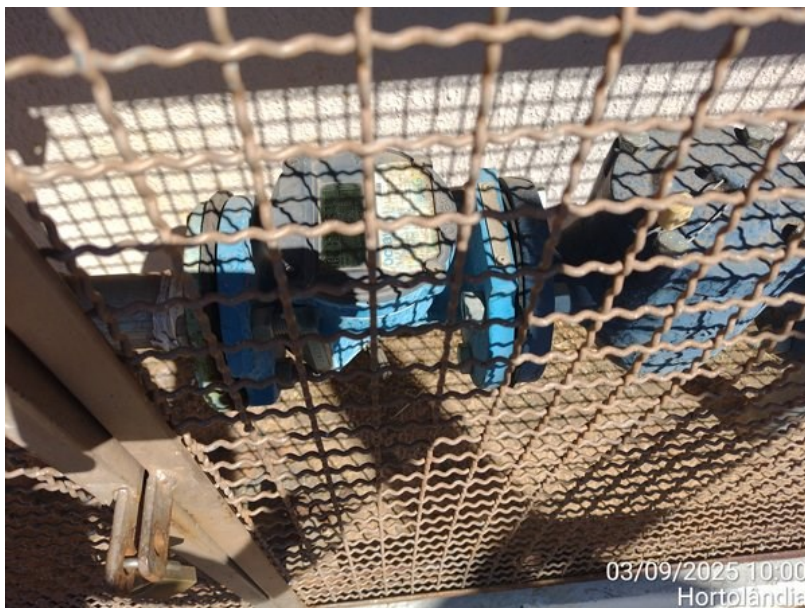
Medidor de água
