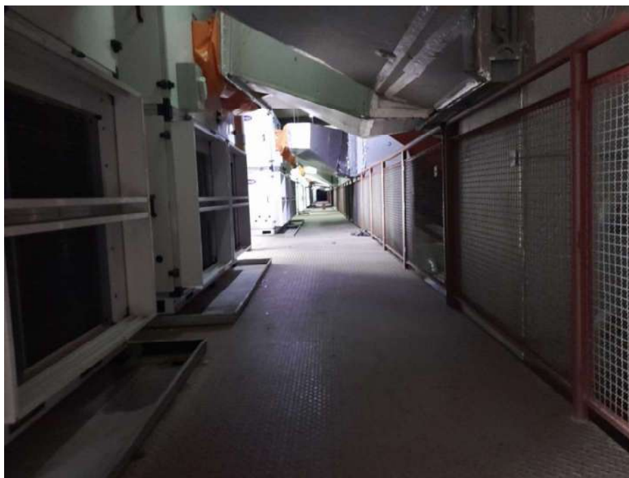
Vista dos aparelhos de ar-condicionado.
