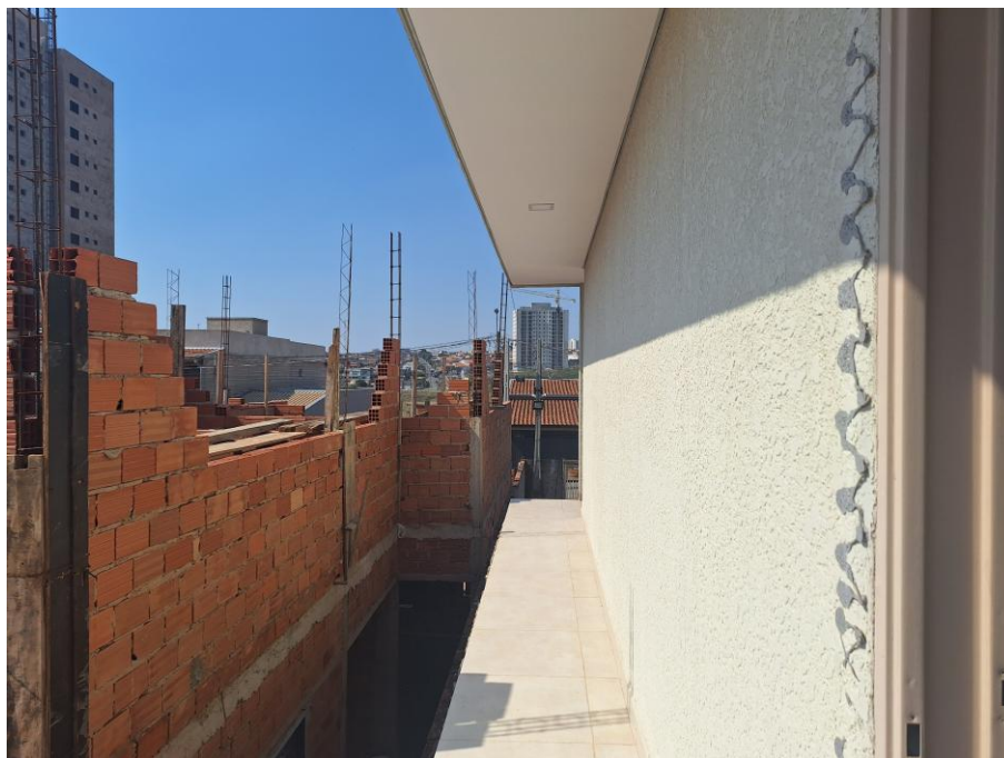
Imagem 96 – Vista Interna – VARANDA. Imóvel verificado durante a DILIGÊNCIA / VISTORIA , pela PERÍCIA DO JUÍZO no local apontado nos autos. Obras em andamento. Trabalhos foram acompanhados pelos representantes do EXECUTADO . Acesso franqueado pelo EXECUTADO . Rua Neusa Camargo de Oliveira, nº 150, Jardim das Figueiras II, Hortolândia/SP.
