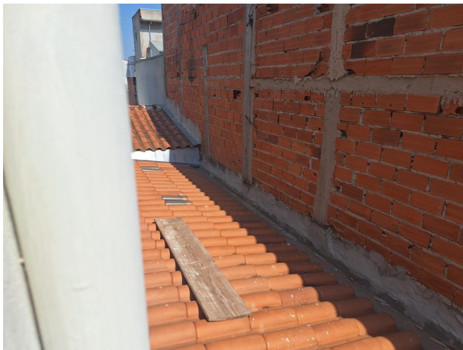
Imagem 88 – Vista Interna – VARANDA. Imóvel verificado durante a DILIGÊNCIA / VISTORIA, pela PERÍCIA DO JUÍZO no local apontado nos autos. Obras em andamento. Trabalhos foram acompanhados pelos representantes do EXECUTADO. Acesso franqueado pelo EXECUTADO. Rua Neusa Camargo de Oliveira, nº 150, Jardim das Figueiras II, Hortolândia/SP.
