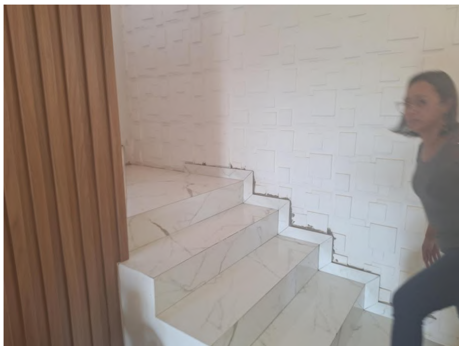
Imagem 48 – Vista Interna – ESCADA DE ACESSO AO PISO SUPERIOR. Imóvel verificado durante a DILIGÊNCIA / VISTORIA, pela PERÍCIA DO JUÍZO no local apontado nos autos. Paredes em alvenaria / reboco / pintura. Piso cerâmico. Trabalhos foram acompanhados pelos representantes do EXECUTADO. Acesso franqueado pelo EXECUTADO.
