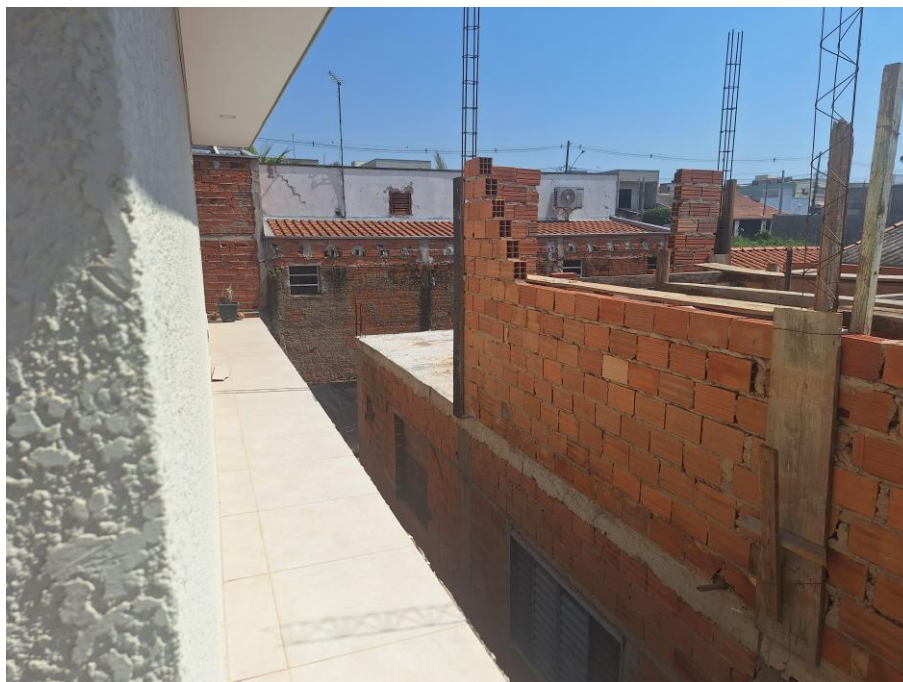
Imagem 66 – Vista Interna – VARANDA. Imóvel verificado durante a DILIGÊNCIA / VISTORIA, pela PERÍCIA DO JUÍZO no local apontado nos autos. Obras em andamento. Piso cerâmico. Trabalhos foram acompanhados pelos representantes do EXECUTADO. Acesso franqueado pelo EXECUTADO. Rua Neusa Camargo de Oliveira, nº 150, Jardim das Figueiras II, Hortolândia/SP.
