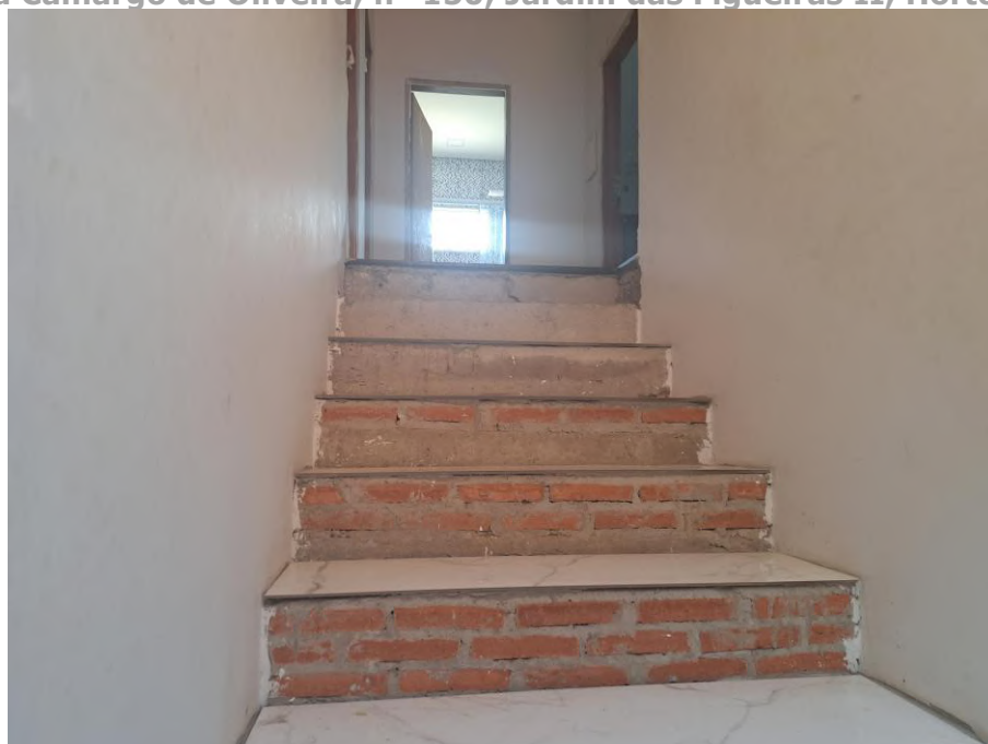
Imagem 49 – Vista Interna – ESCADA DE ACESSO AO PISO SUPERIOR. Imóvel verificado durante a DILIGÊNCIA / VISTORIA, pela PERÍCIA DO JUÍZO no local apontado nos autos. Paredes em alvenaria / reboco / pintura. Piso cerâmico. Trabalhos foram acompanhados pelos representantes do EXECUTADO. Acesso franqueado pelo EXECUTADO.
