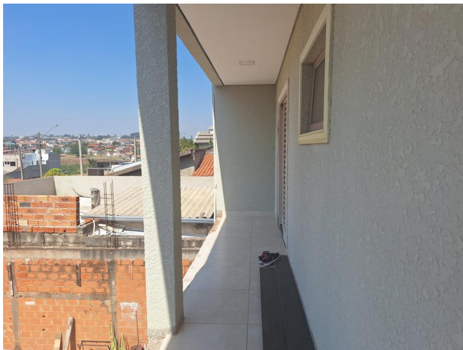
Imagem 72 – Vista Interna – VARANDA. Imóvel verificado durante a DILIGÊNCIA / VISTORIA, pela PERÍCIA DO JUÍZO no local apontado nos autos. Obras em andamento. Piso cerâmico. Trabalhos foram acompanhados pelos representantes do EXECUTADO. Acesso franqueado pelo EXECUTADO. Rua Neusa Camargo de Oliveira, nº 150, Jardim das Figueiras II, Hortolândia/SP.
