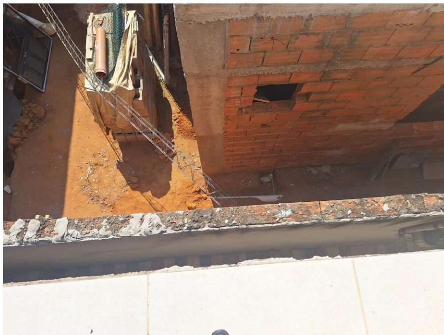
Imagem 94 – Vista Interna – VARANDA. Imóvel verificado durante a DILIGÊNCIA / VISTORIA, pela PERÍCIA DO JUÍZO no local apontado nos autos. Obras em andamento. Trabalhos foram acompanhados pelos representantes do EXECUTADO. Acesso franqueado pelo EXECUTADO. Rua Neusa Camargo de Oliveira, nº 150, Jardim das Figueiras II, Hortolândia/SP.
