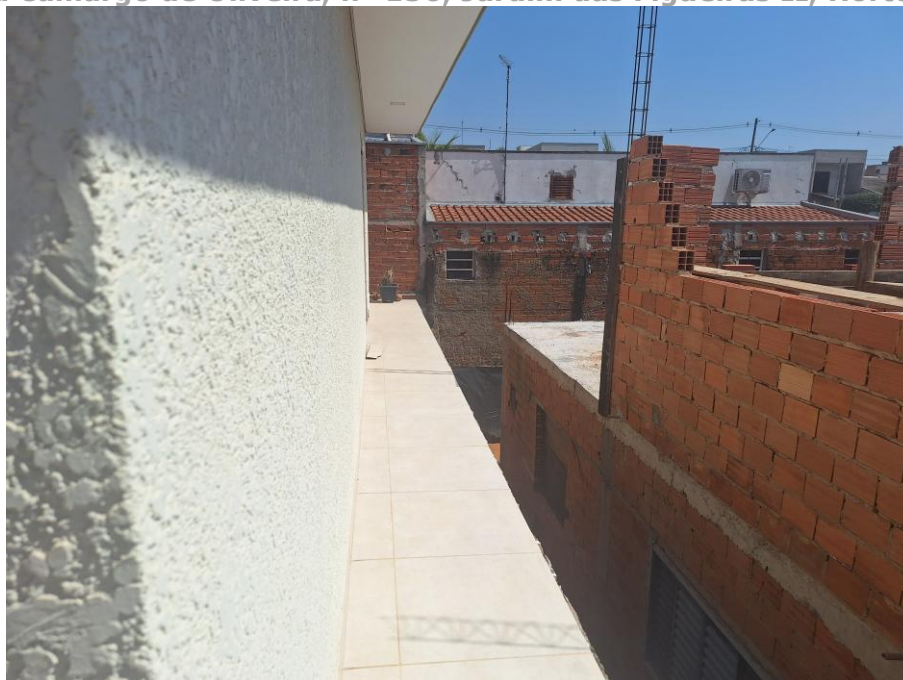
Imagem 67 – Vista Interna – VARANDA. Imóvel verificado durante a DILIGÊNCIA / VISTORIA, pela PERÍCIA DO JUÍZO no local apontado nos autos. Obras em andamento. Piso cerâmico. Trabalhos foram acompanhados pelos representantes do EXECUTADO. Acesso franqueado pelo EXECUTADO. Rua Neusa Camargo de Oliveira, nº 150, Jardim das Figueiras II, Hortolândia/SP.
